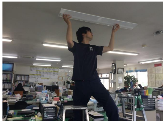
＜電気量削減＞LED交換
